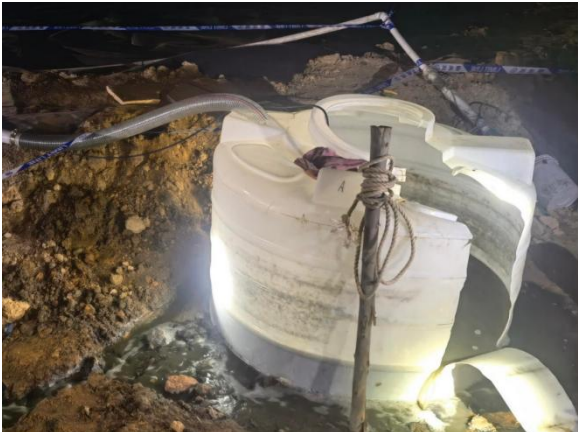
图 2 事故现场沼液罐
